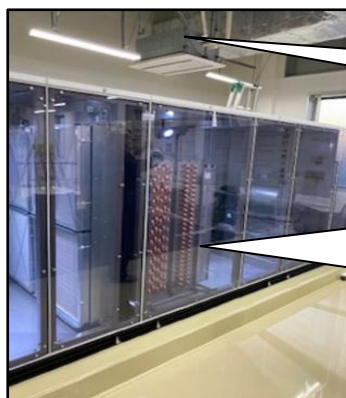
2階スケルトン空調機
