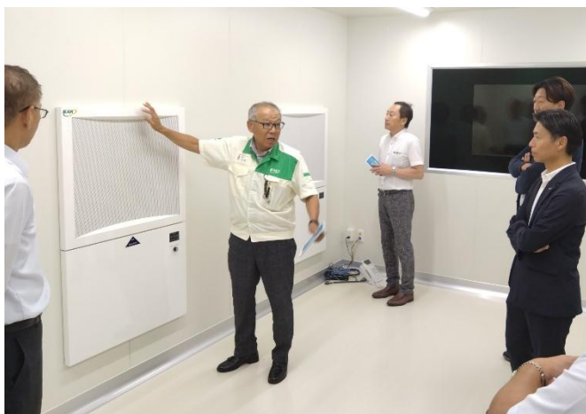
3Fクリーンルーム／空調システム
